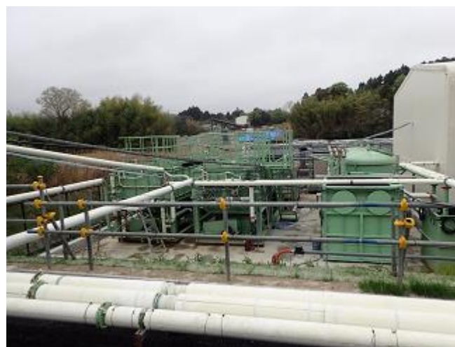
土壌貯蔵施設の浸出水処理施設の確認
