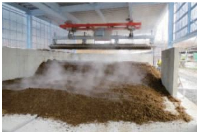
図1 堆肥クレーン設置稼働状況
