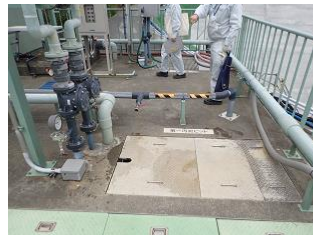
浸出水処理施設の稼働状況の確認
