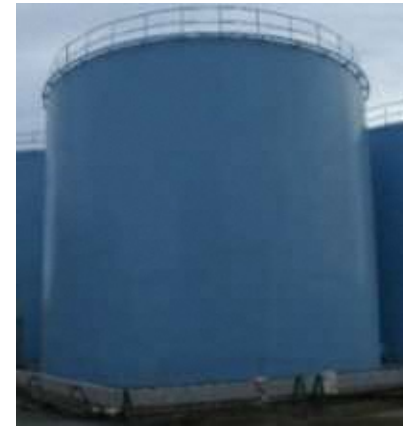
溶接型タンク
