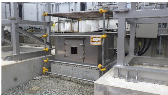
(写真1-1) 増強ピットNo.209の状況
