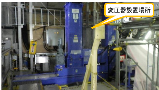
（写真1-1）変圧器設置場所の状況 （高温焼却炉建屋入口（東側）から撮影）
