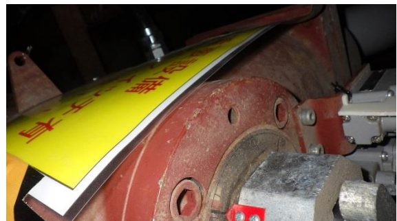
(写真2) 黄色の物が注意喚起表示「重要設備 弁リミットスイッチ有 接触注意」と記載(写真1の奥側方向から撮影)
