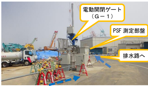
(写真2) 電動開閉ゲートG-1の状況 （南側から撮影）
