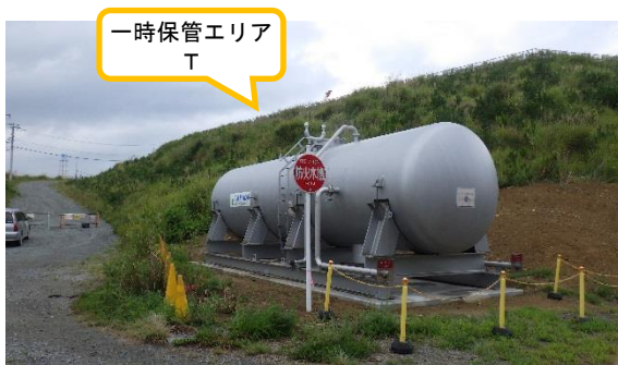
(写真4) 一時保管エリアTの出入口に設置された防火水槽の状況 (出入口(南西側)から撮影)
