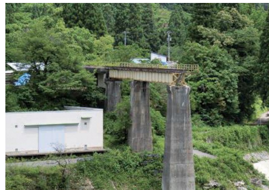
▲流された只見川第6橋りょう（金山町）
