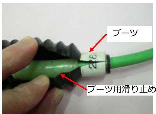
①ブーツ用滑り止めのずれ
