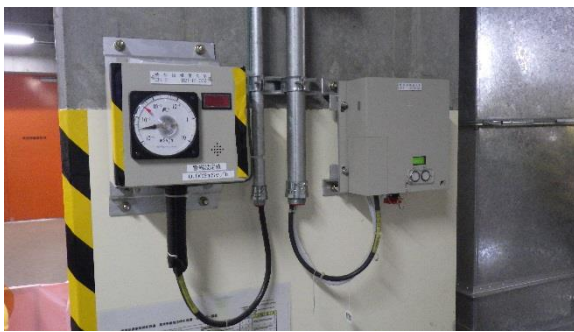
(写真2) 焼却設備室A系のエリア放射線モニタの状況
