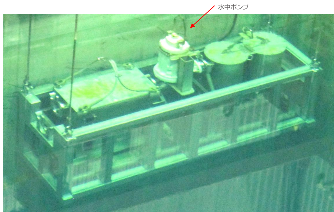
吸引装置設置状況
