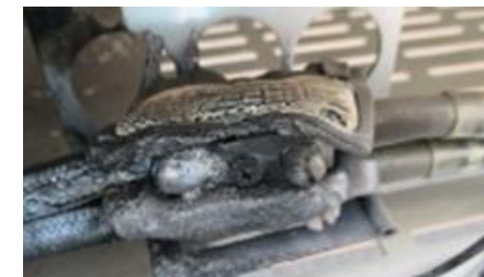
ブレーキレジスタ内の損傷（5月12日）
