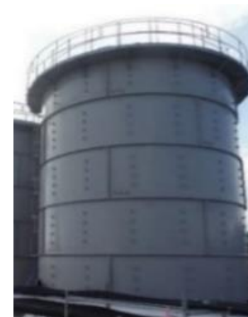
フランジ型タンク
