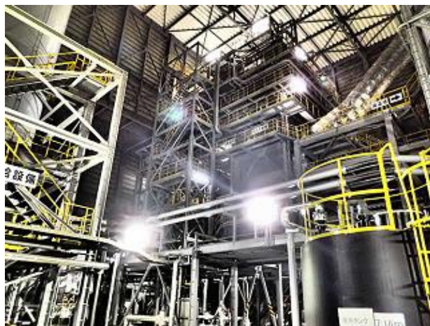
仮設焼却施設及び冷却塔の状況の確認
