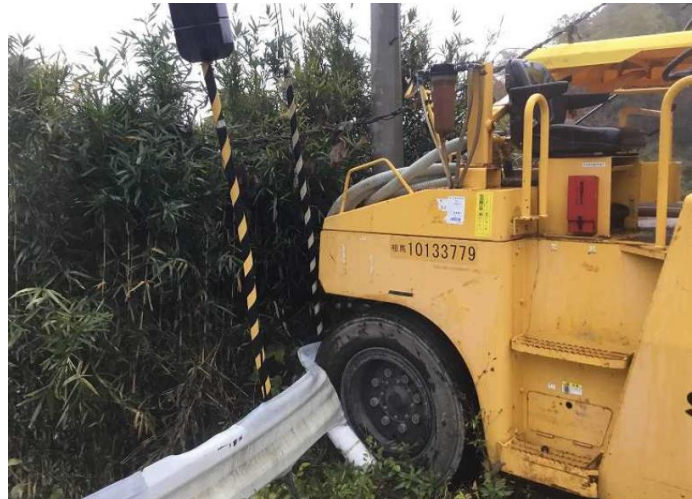
事故の発生現場の様子
