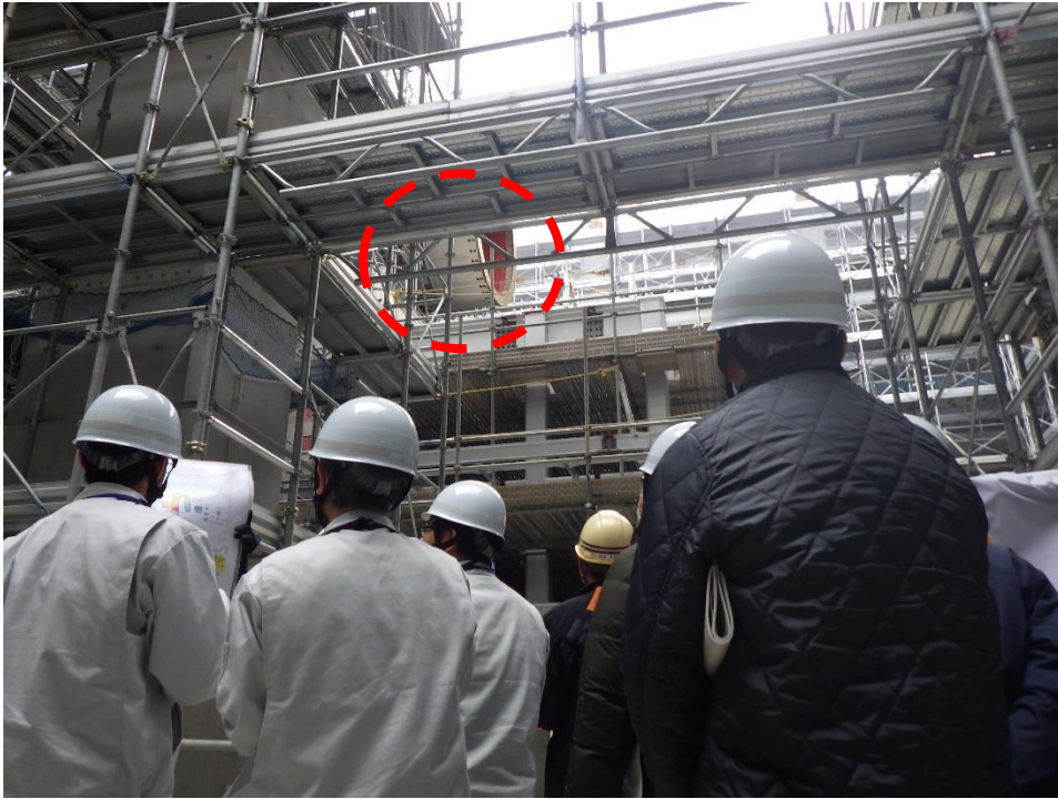
② 増設雑固体廃棄物焼却設備内部の様子①
