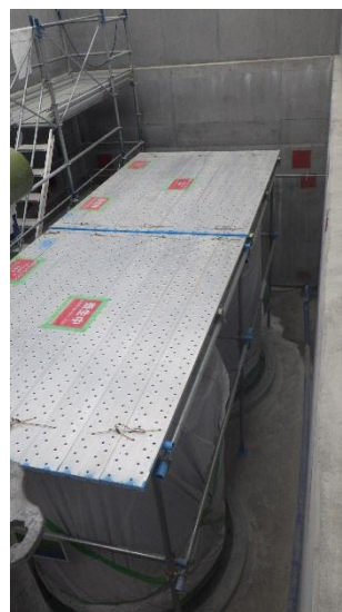
（写真2）ドレンタンク室のタンク
