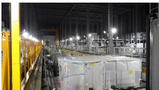
(写真6) 増設多核種除去設備建屋内
