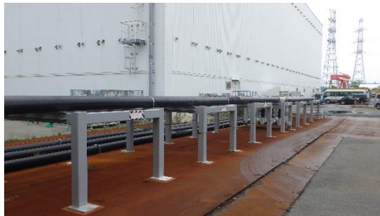
（写真1） 増設多核種除去設備西側
