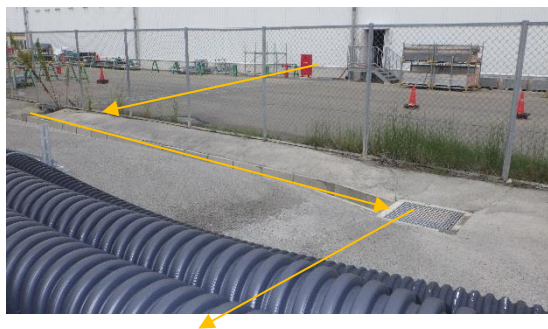
(写真3) 増設多核種除去設備南側 黄色の矢印はA排水路へ接続する側溝を示す。
