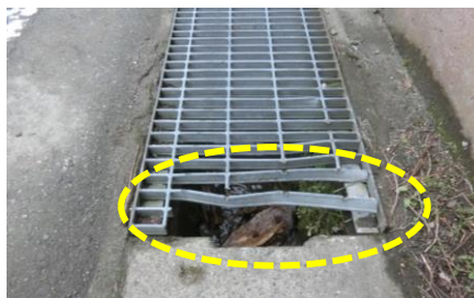
側溝蓋の破損 （歩行者のケガにつながります）
