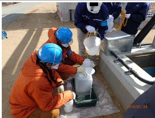
土壤貯蔵施設におけるシート下部地下水集排水設備排水の測定
