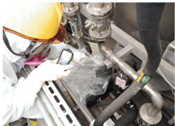
既設 ALPS 吸着塔の状況確認
