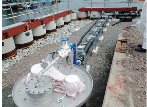
海側遮水壁と地下水ドレンボンド
