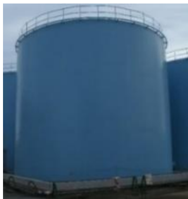
溶接型タンク
