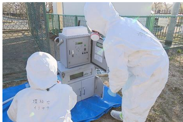
緊急時モニタリング訓練④ （可搬型MPの設置）
