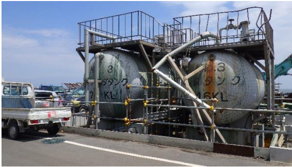
(写真6) 薬品タンク (No.3 苛性ソーダタンク、 No.3 硫酸タンク) (西側から撮影)
