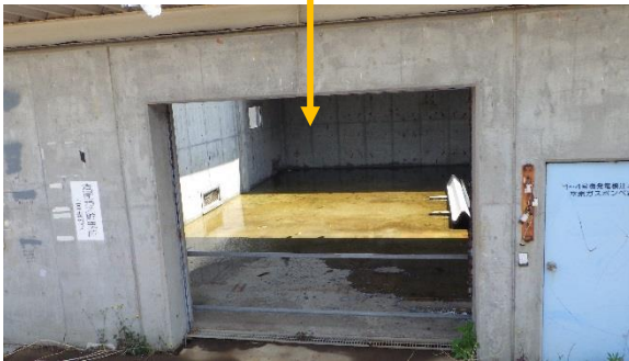
(写真3-1) 1～4号機発電機注入用窒素ガス ポンベ室建屋内の状況
