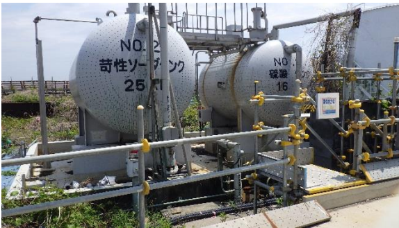
(写真4) 薬品タンク (No.2 苛性ソーダタンク、 No.2 硫酸タンク) (西側から撮影)
