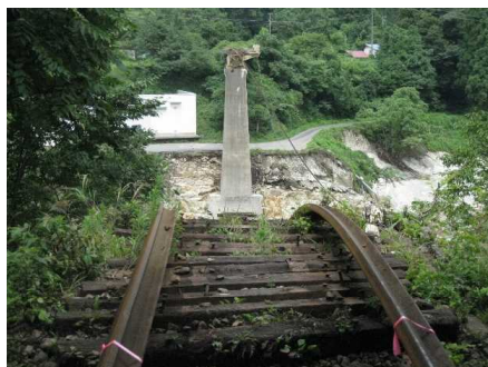
流出した第六只見川橋梁 (金山町)
