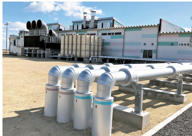
熱エネルギーを供給するパイプライン
