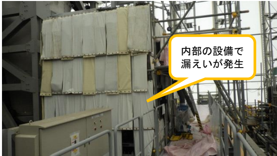
(写真1) 漏えい発生箇所周囲の状況
