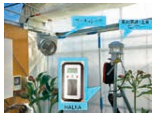
可搬型デバイス HALKA による遠隔監視制御システム
