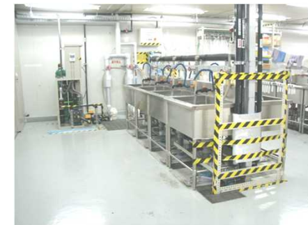
アルカリ水・次亜塩素酸水 洗浄シンク写真
