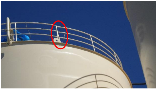
(写真1-2) 赤丸部分の手摺りが歪んでいる
