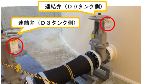
(写真3-1) 赤丸部分が操作禁止を示す標札
