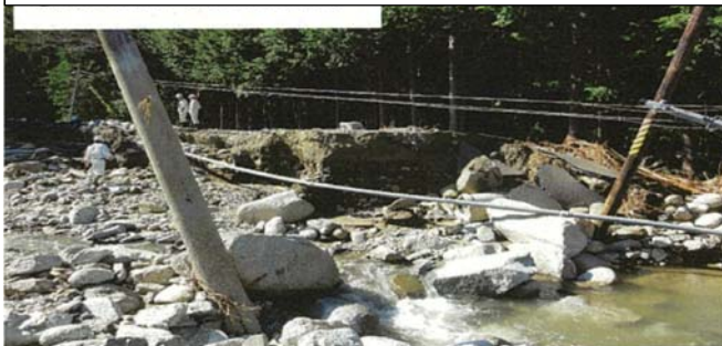
道路流出による配水管露出（相馬市山上地区）
