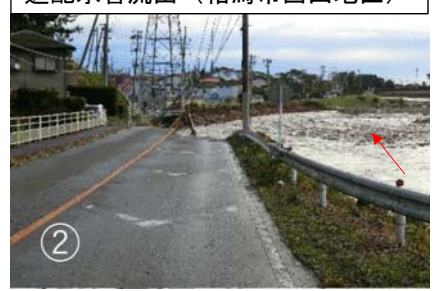
送配水管流出（相馬市西山地区）
