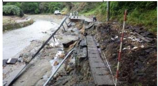
配水管破損（二本松市）
