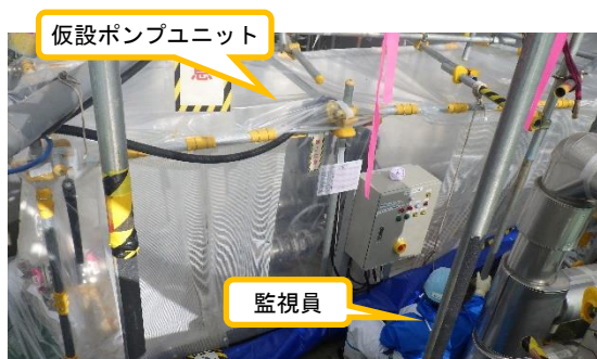
(写真1) 仮設のポンプユニットはビニールで 周囲が養生されている
