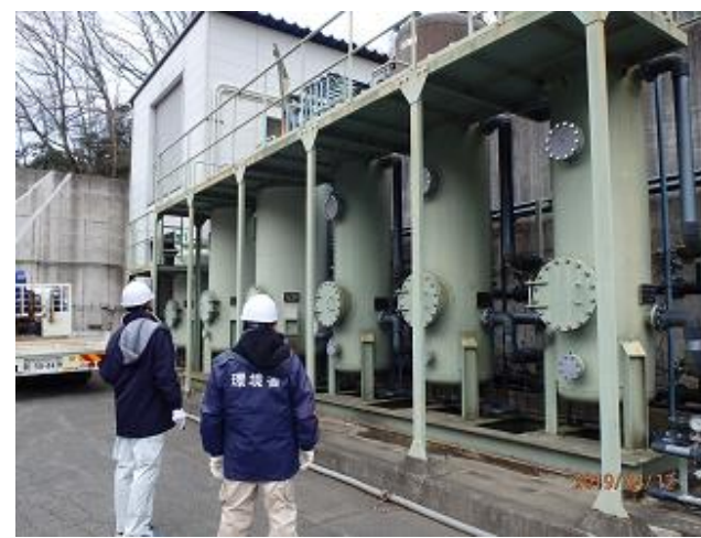
浸出水処理施設の稼働状況の確認
