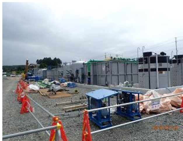
浸出水処理施設の設置状況の確認
