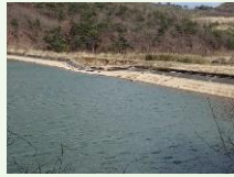
波除工崩落(改修前)
