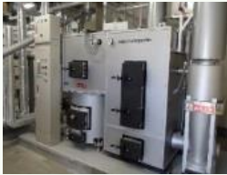
木質ペレットボイラー
