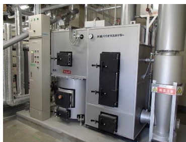
木質ペレットボイラ施設 (西会津町)
