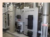
木質ペレットボイラー
