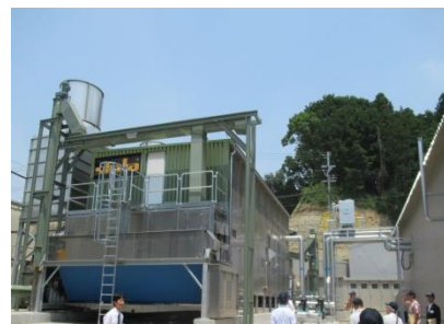
ペレット製造施設（いわき市）
