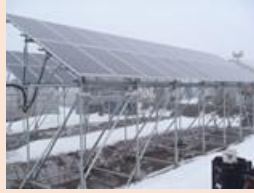
導入した太陽光パネル
