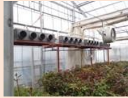
導入したヒートポンプ
