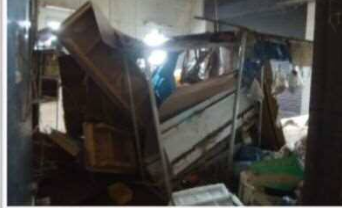
汚泥処理棟被災状況
