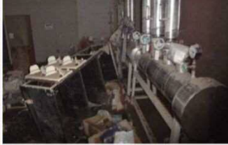
管理棟ボイラー室被災状況
