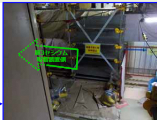
<Y靴交換エリア（暫定対策後）>
