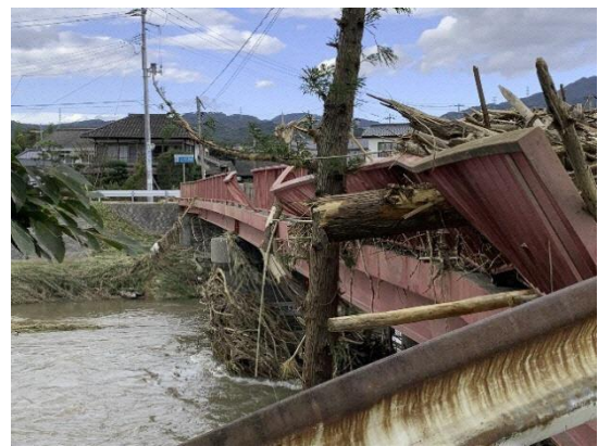
いわき市夏井川(小川地区)の災害状況
