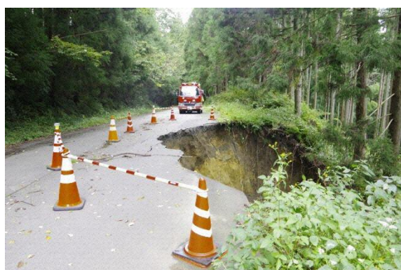
いわき市(田人町旅人字熊ノ倉地区)の土砂災害の状況
