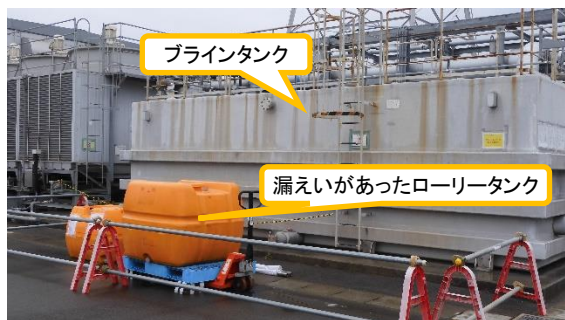
(写真1-1) 漏えいがあったローリータンク周囲 の状況
