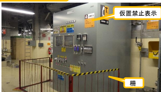
(写真2) FPC及びF/D制御盤周囲の状況
