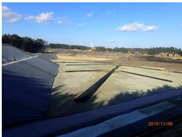
土壌貯蔵施設の稼働状況の確認
