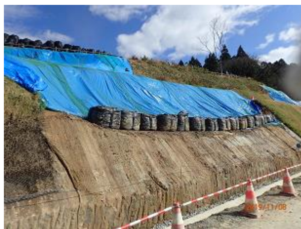
土壌貯蔵施設の被災状況の確認
