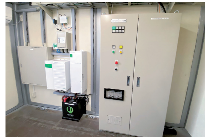
単相システム（インバータ、蓄電池、高度化自動切替器）
