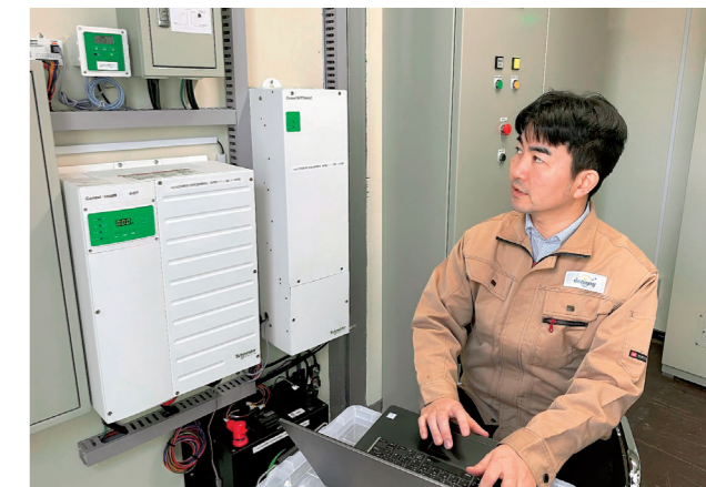
系統待機型オフグリッド蓄電システム開発作業
