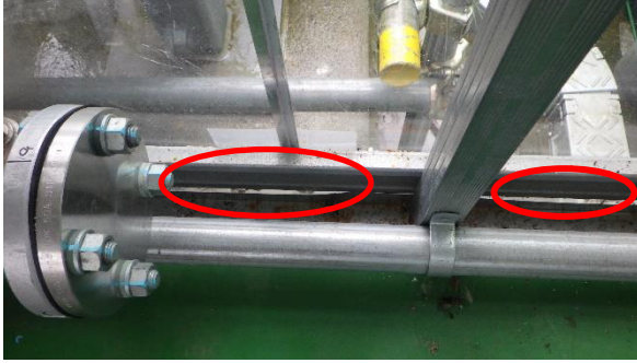
(写真3) ポンプ室の壁と床面の隙間の状況 (写真赤枠内が隙間)
