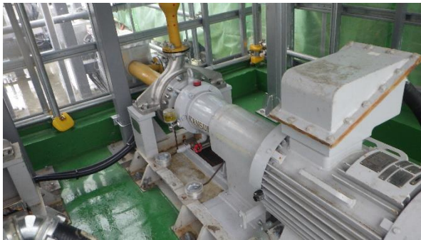
(写真2-1) ポンプ室内部移送ポンプDの状況
