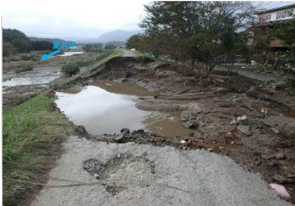
被災状況（令和元年10月13日撮影）
