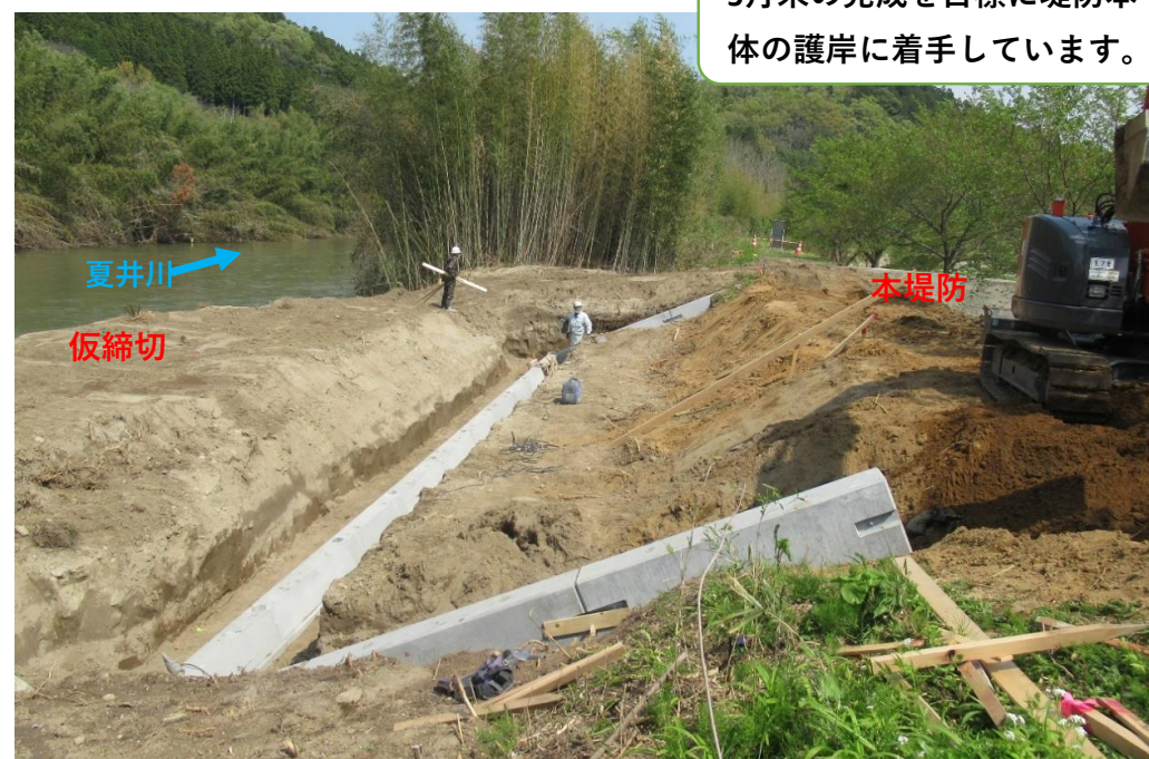
堤防護岸 コンクリート張ブロック施工中 施工状況 (令和2年4月30日)
