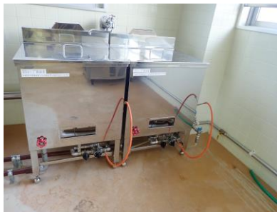
ガス式ボイル槽
