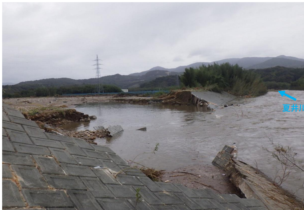
被災状況 (令和元年10月13日撮影)
